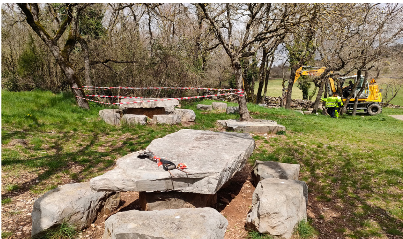
▲ Les roches, gélives, s'étaient fortement dégradées avec le temps et nécessitaient d'être évacuées
